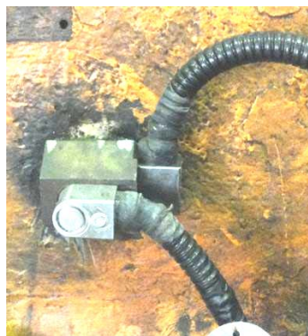
شکل ۲: سنسورهای ارتعاشات مطلق در دو جهت افقی و محوری
